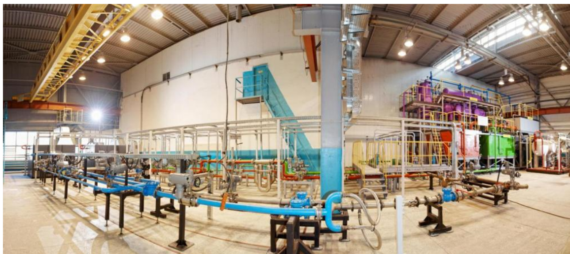
Рис.1. Внешний вид научно-испытательного стенда. По голубым трубам осуществляется движение газа. По серым трубам движется жидкая фаза в виде смеси Eххsol и воды. Блок сепарации, сиреневого цвета, расположен в дальнем верхнем правом углу фотографии. Коричневый и зеленый баки заполнены имитатором нефти Eххsol и водой соответственно.
